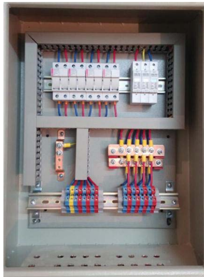
شکل ۱۲- تابلو برق AC
