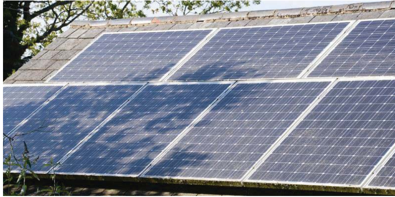
شکل ۲۷- سایه روی مدول‌های فتوولتائیک با توجه به اشیا اطراف
