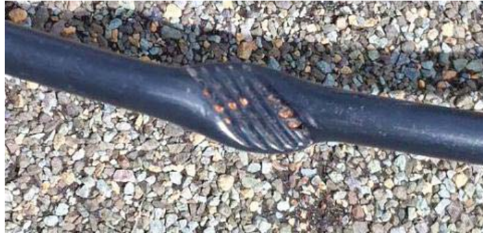
شکل ۱۰۶- عایق بندی نادرست
