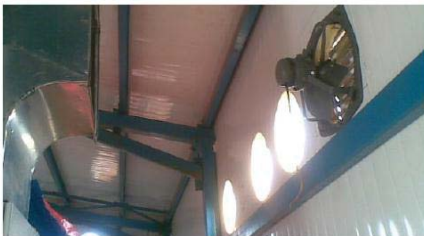
شکل ۸۷ - اتاق تهویه اینورتر
