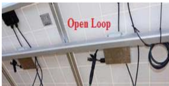
شکل ۱۰۳- فرم بندی نادرست کابل‌ها در روش حلقه باز
