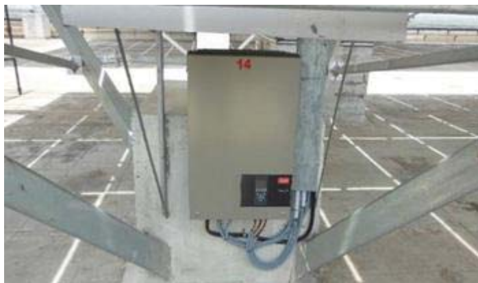
شکل ۹۳- ارتفاع نصب اینورتر از زمین
