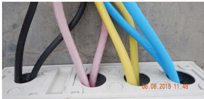
شکل ۱۰۷- نحوه اشتباه عبور کابل به تابلوها یا جعبه تقسیم ها (ورودی کابل به درون تابلوها یا جعبه تقسیم‌ها باز است)
