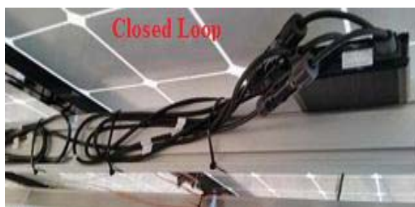
شکل ۱۰۲- فرم بندی نادرست کابل‌ها در روش حلقه بسته
