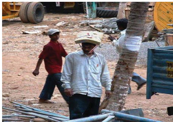
شکل ۱۴۸- عملکرد نادرست، عدم استفاده از کلاه ایمنی
