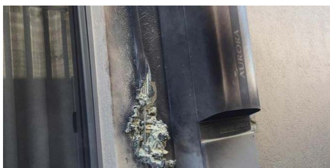
شکل ۸۲- آسیب دیدگی اینورتر ناشی از سوختن (سوختگی خارجی)
