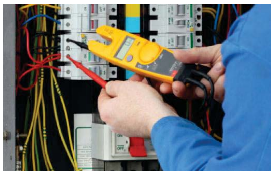
شکل ۱۵۶- روش نادرست - بدون استفاده از دستکش ایمنی
