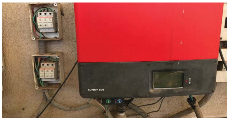
شکل ۸۶- شل بودن کاندویت‌ها و کابل‌های اینورتر
