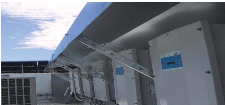
شکل ۸۵- اینورتر نصب شده زیر سایه بان
